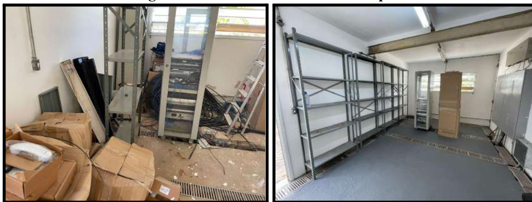
Figura 3 - Sala do telecom antes e depois
